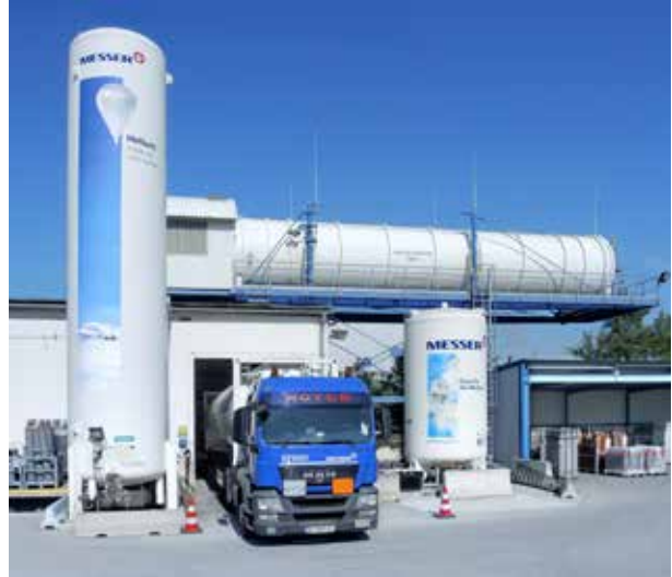
Liegender 120'000 Liter Speicherbehälter
